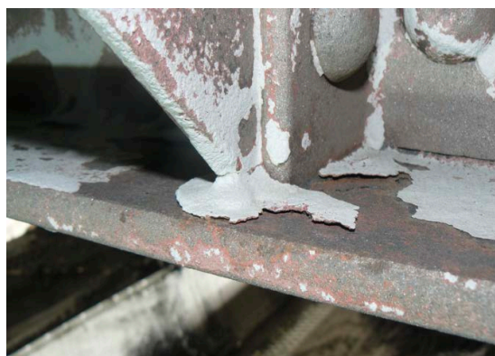
Ancien fonds avant application de la première couche du système de peinture.
