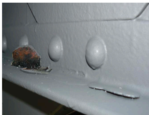
Exemple de décollement des anciens fonds après application de la première couche du système de peinture.
